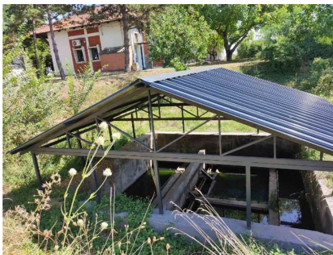
Slika 3.5.3. Postojeći separator masti i ulja, na kat. parc.br. 1655/2 KO Jakovo
