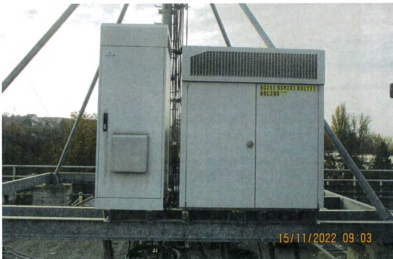
Slika 4: Kabineti bazne stanice BG-Bele Vode 2 operatora Telekom Srbija
