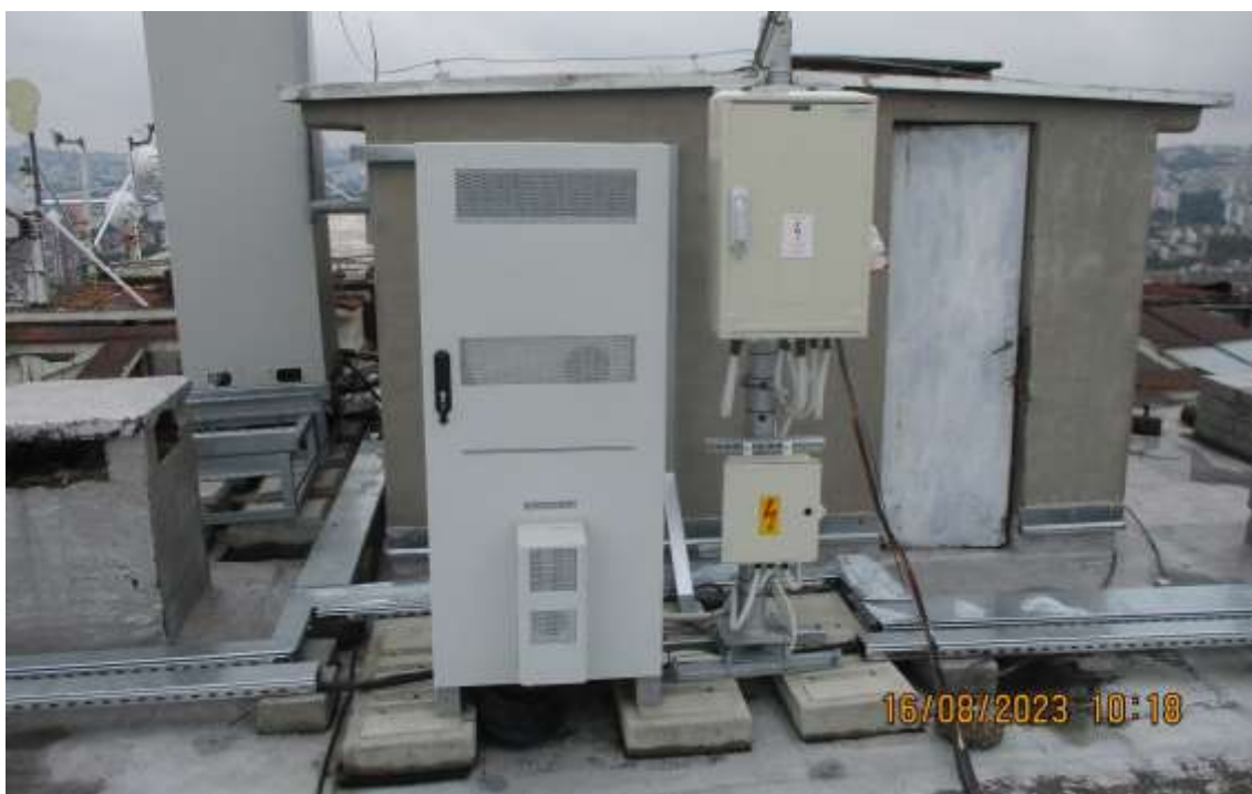
Slika 2.5 Prikaz kabineta bazne stanice na krovu objekta
