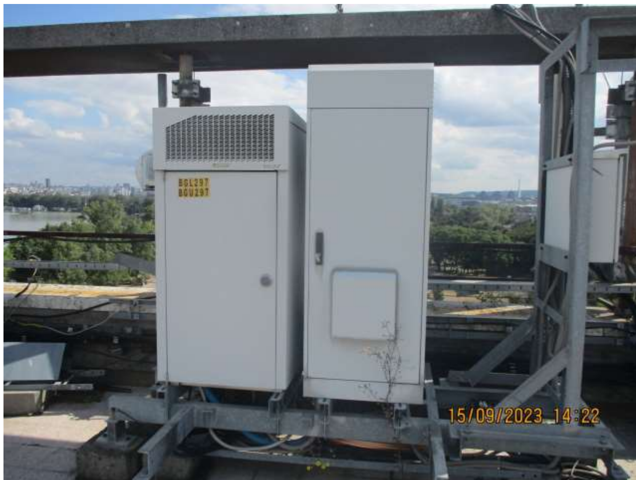
Slika 7: Kabineti bazne stanice
