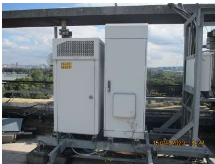
Slika 2.5 Kabineti pedmetne BS na krovu objekta
