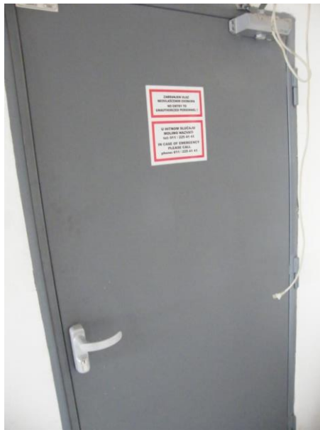
Slika 2.2.b. Fotografija prostorijom sa kabinetom bazne stanice predmetnog izvora zračenja operatera A1 na lokaciji
