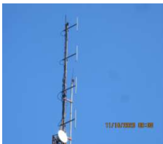
Slika 2.5 Fotografija antenskog sistem predmetne radio stanice
