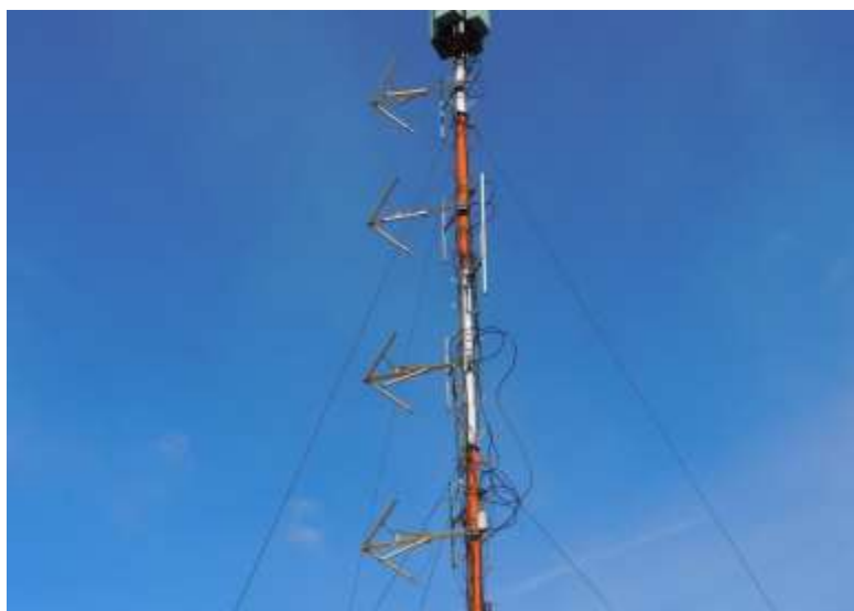
Slika 2.5 Fotografija antenskog sistem predmetne radio stanice
