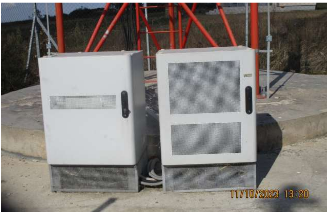
Slika 7: Kabineti bazne stanice
