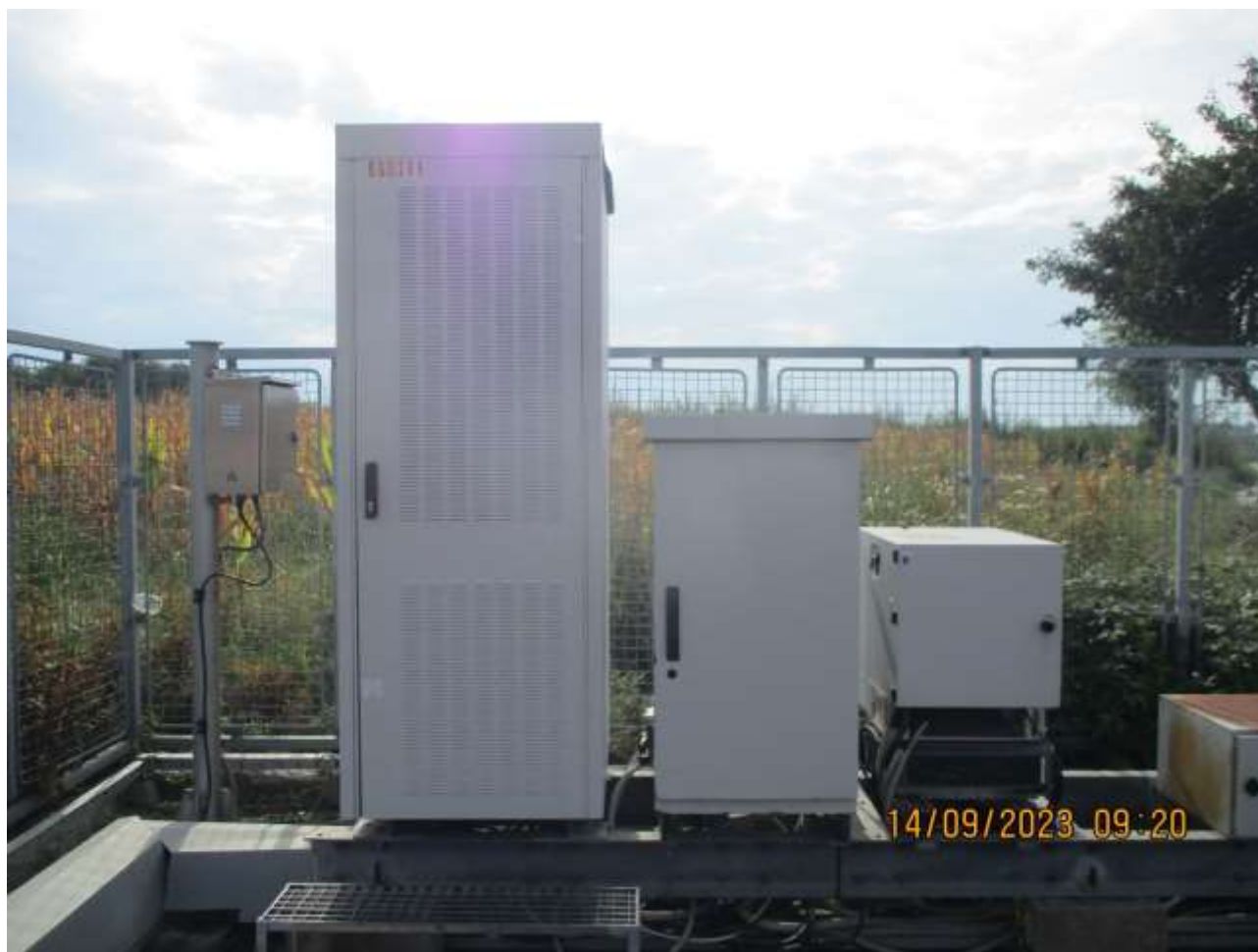
Slika 8: Kabineti bazne stanice
