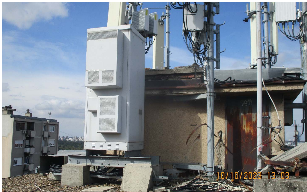
Slika 4: Kabinet bazne stanice
