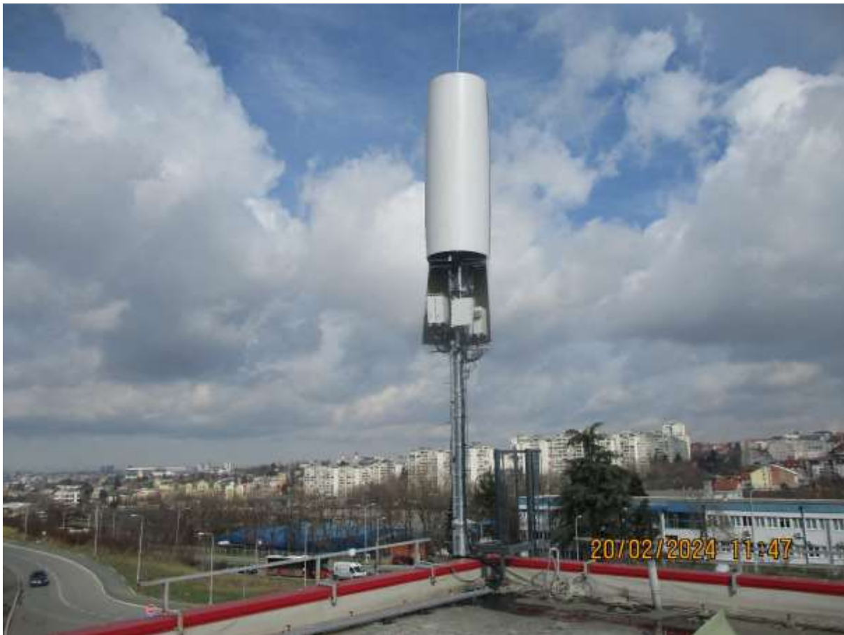
Slika 2.6 Prikaz antenskog sistema na krovu objekta
