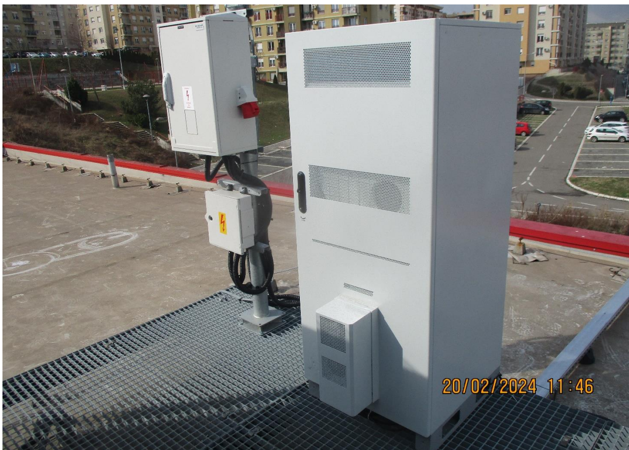
Slika 4: Prikaz kabineta bazne stanice
