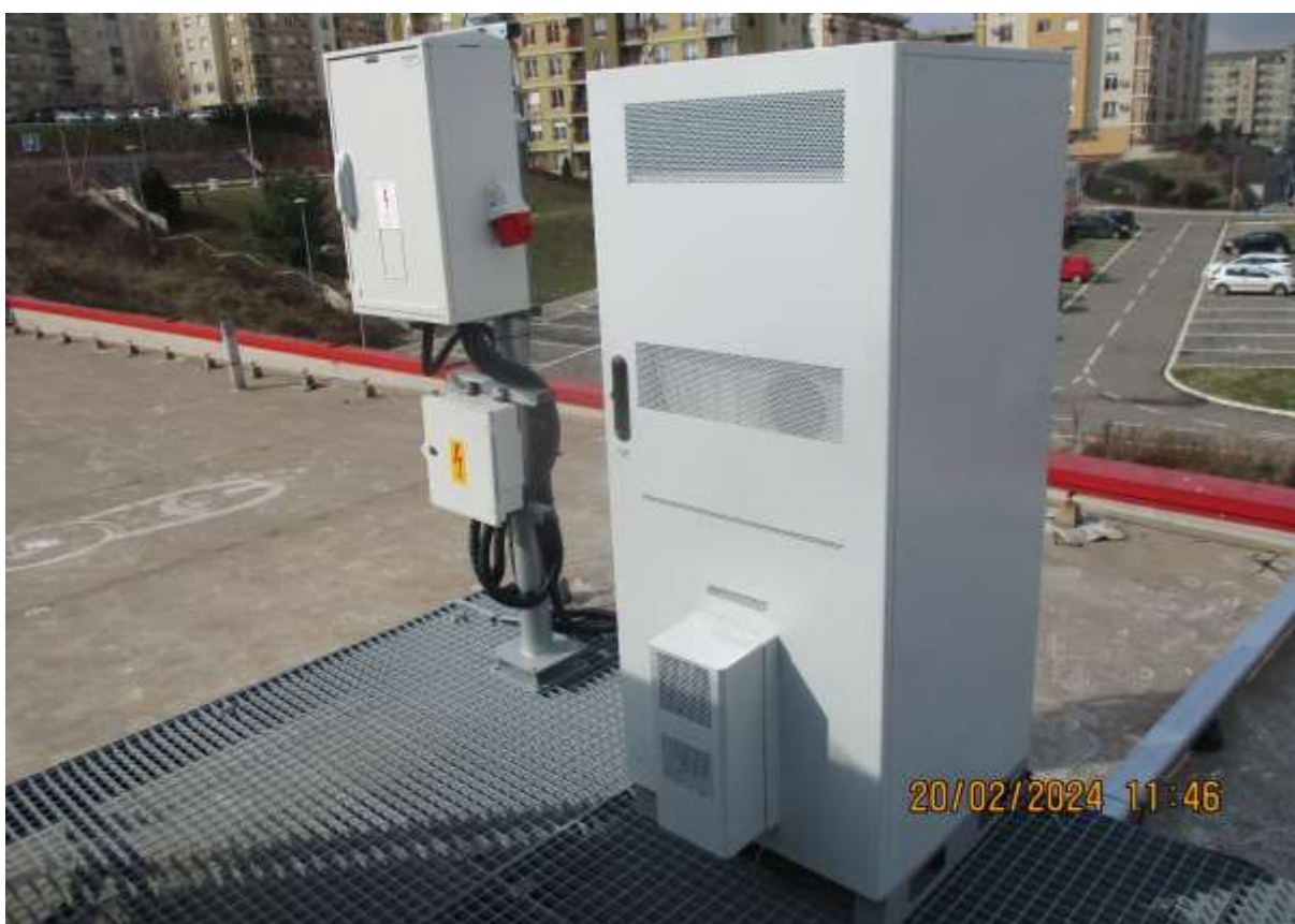
Slika 2.5 Prikaz kabineta bazne stanice na krovu objekta
