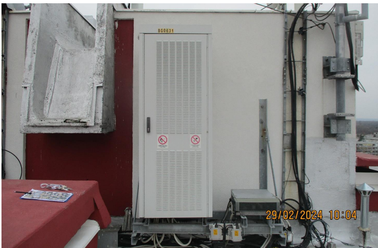
Slika 4: Prikaz kabineta bazne stanice
