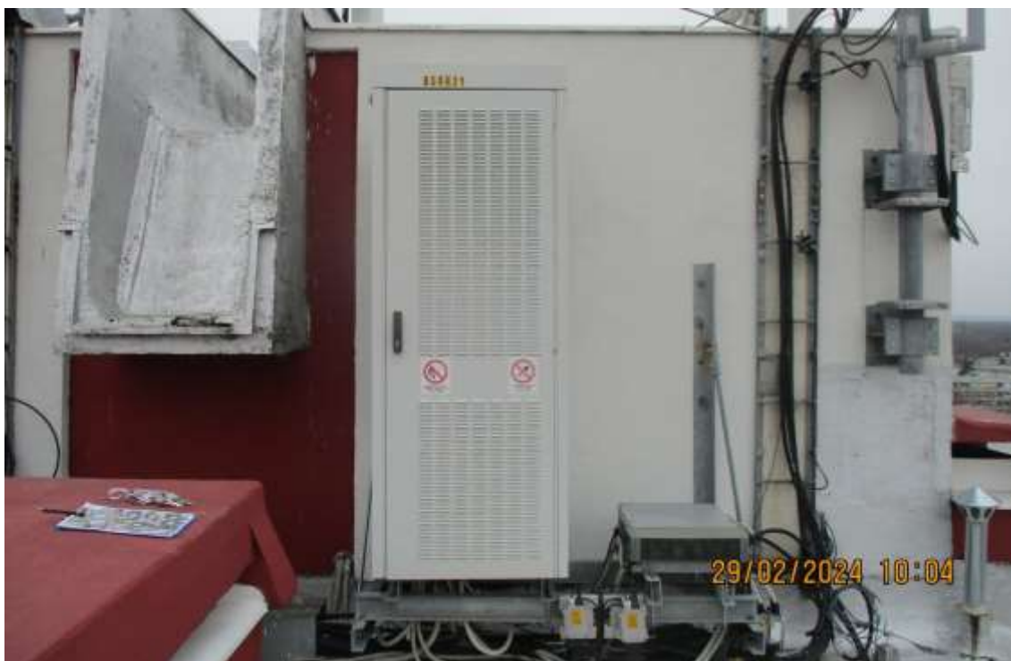
Slika 2.5 Kabinet bazne stanice na krovu objekta
