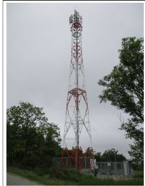
Lokacija bazne stanice
