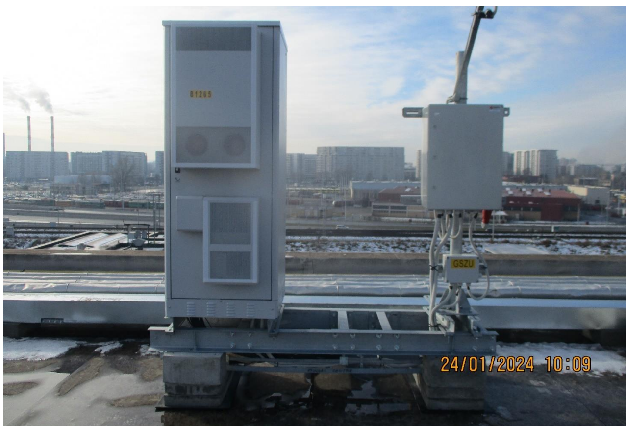
Slika 8: Prikaz kabineta bazne stanice
