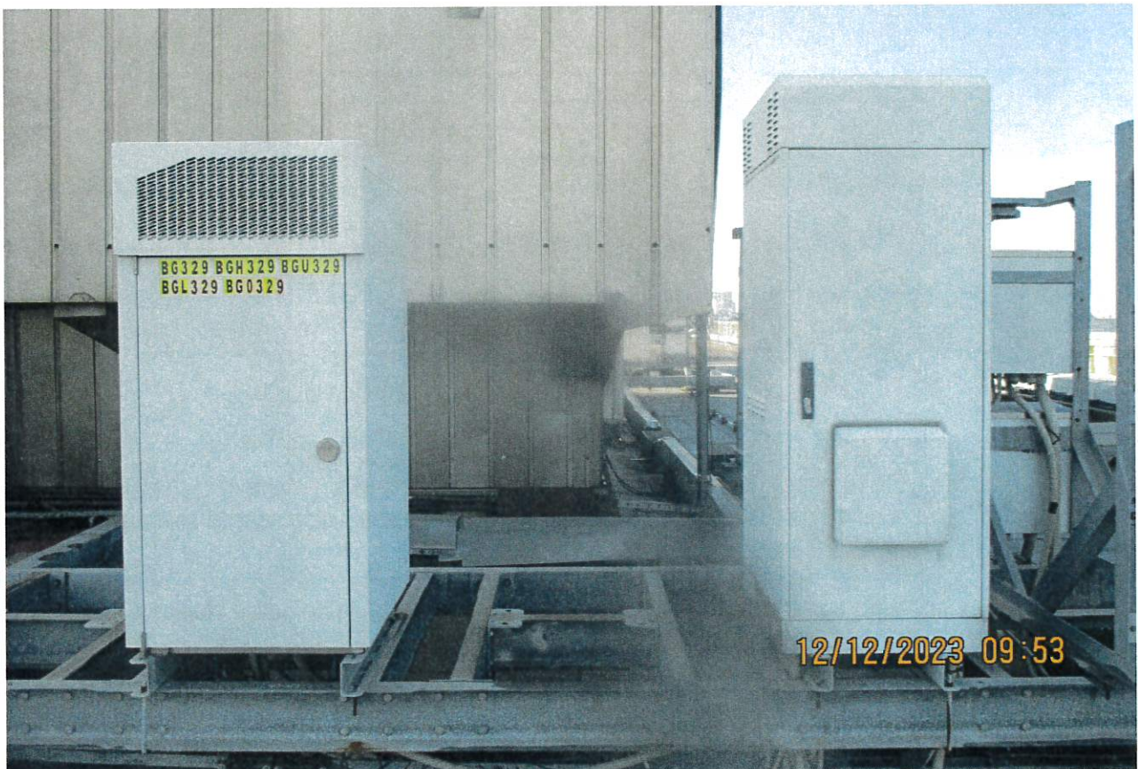
Slika 4: Kabineti bazne stanice
