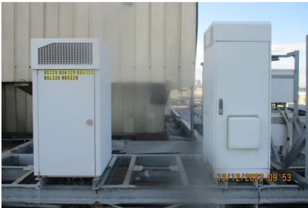
Slika 2.5 Kabineti pedmetne BS na krovu objekta
