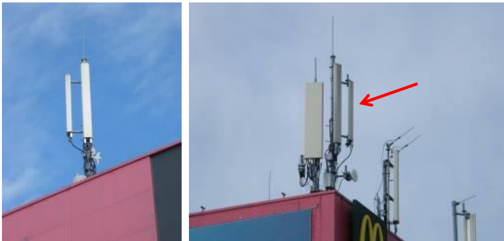
Slika 2.3. Fotografije antenskog sistema i bazne stanice operatera Cetin na lokaciji
