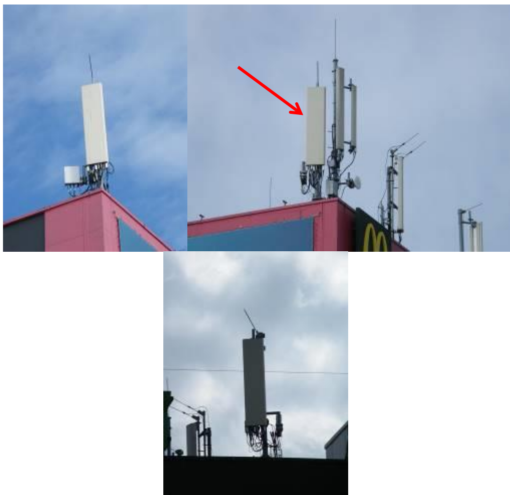
Slika 2.2.a Fotografije antenskog sistema i kabineta predmetne bazne stanice operatera Telekom Srbija
