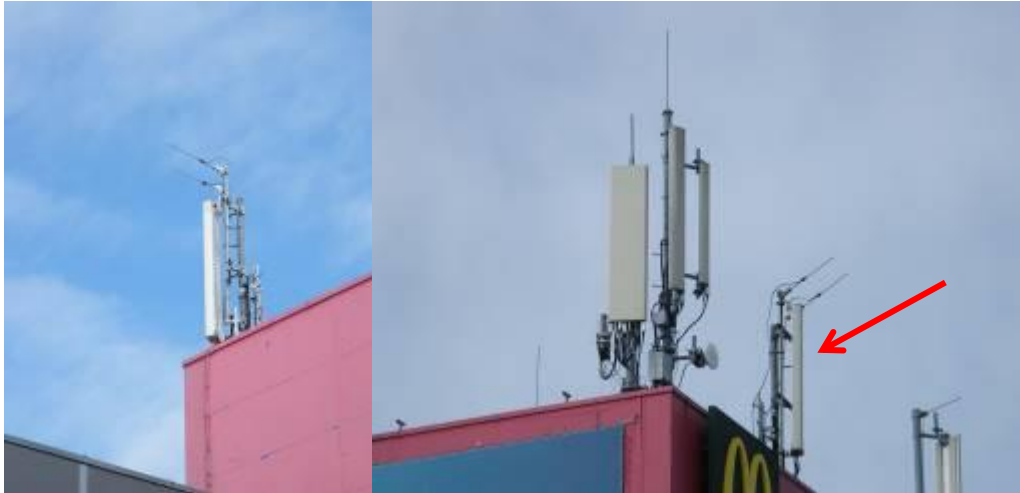
Slika 2.4. Fotografije antenskog sistema i bazne stanice operatera A1 na lokaciji
