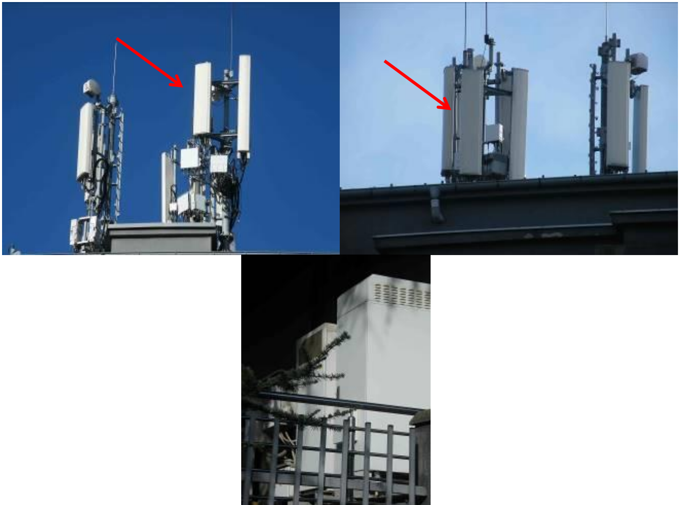
Slika 2.2.a Fotografije antenskog sistema i kabineta predmetne bazne stanice operatera Telekom Srbija
