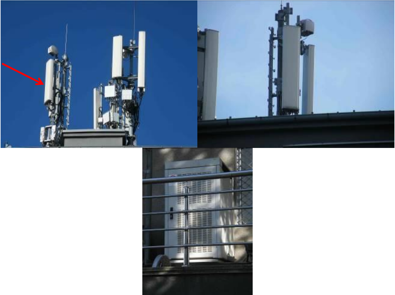
Slika 2.4. Fotografije antenskog sistema i bazne stanice operatera A1 na lokaciji
