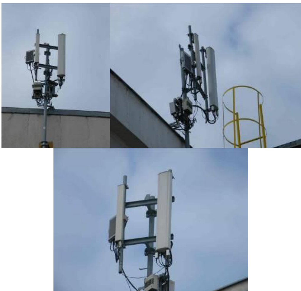
Slika 2.3. Fotografije antenskog sistema predmetne bazne stanice operatera Telekom Srbija
