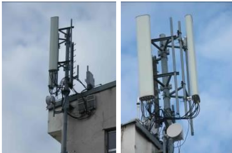
Slika 2.3. Fotografije antenskog sistema i bazne stanice operatera A1 na lokaciji
