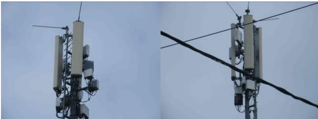
Slika 2.2.a Fotografije antenskog sistema i kabineta predmetne bazne stanice operatera Telekom Srbija
