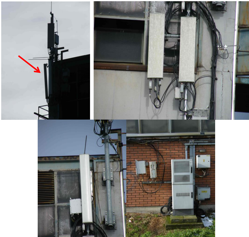
Slika 2.3. Fotografije antenskog sistema i bazne stanice operatera Cetin na lokaciji
