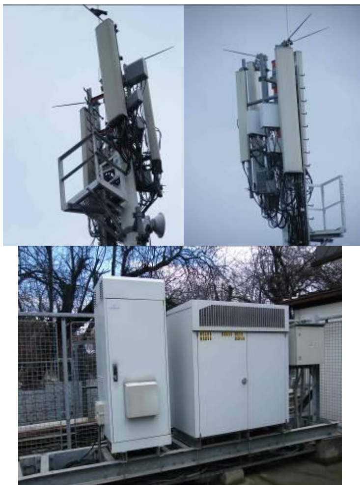
Slika 2.2.a Fotografije antenskog sistema i kabineta predmetne bazne stanice operatera Telekom Srbija
