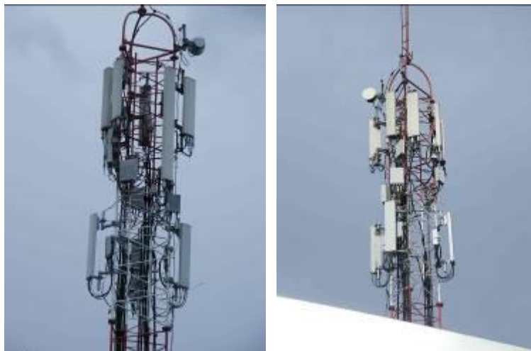
Slika 2.3. Fotografije antenskog sistema i bazne stanice operatera Cetin na lokaciji
