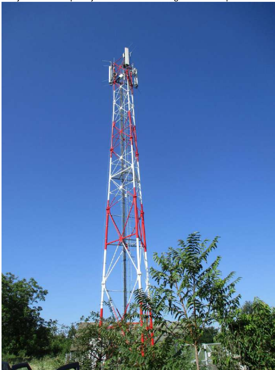
Slika 3.1 Objekat (antenski stub) na kome se nalaze instalacije RBS "BG0769_02 BG_Popovic"
