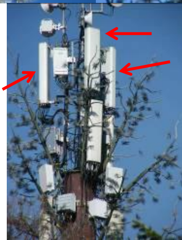
Slika 2.3. Fotografije antenskog sistema i bazne stanice operatera A1 na lokaciji
