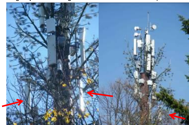
Slika 2.4. Fotografije antenskog sistema i bazne stanice operatera Cetin na lokaciji
